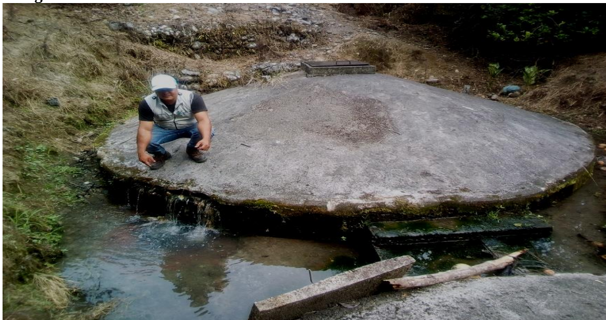
Fotografía N° 8. Planta de tratamiento en mal estado en el recinto San Carlos.
