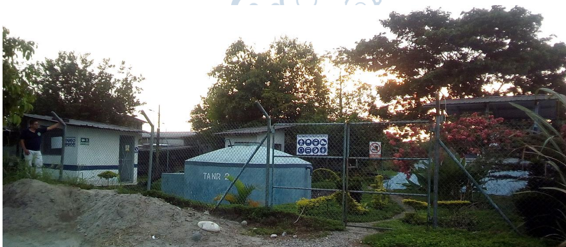
Sistema de agua de la parroquia Sevilla.
