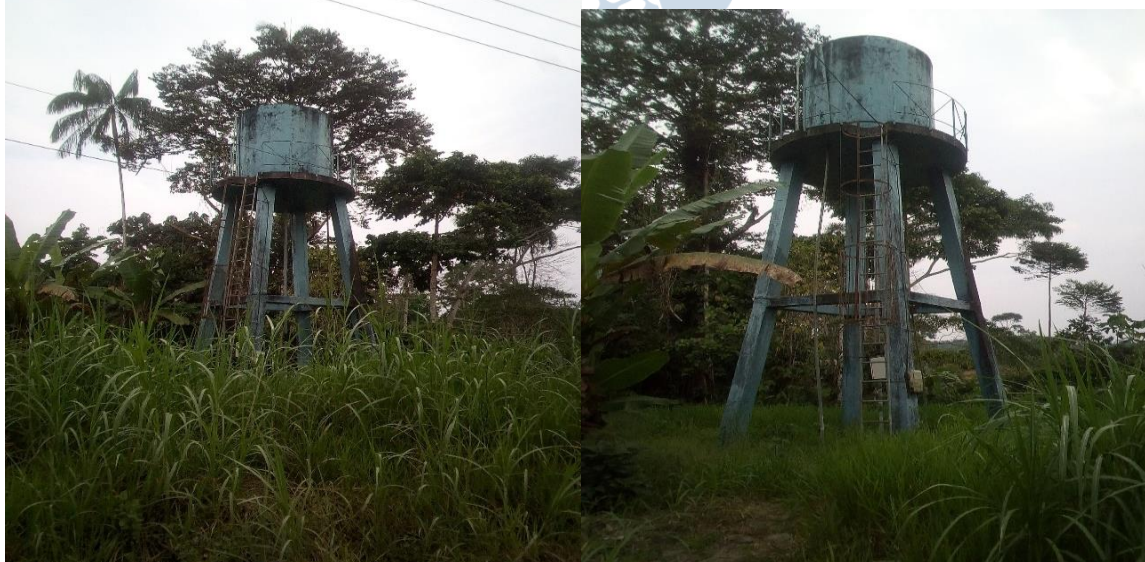
Fotografía N° 6. Sistema de agua rural mejorar la presentación de fotografías.
